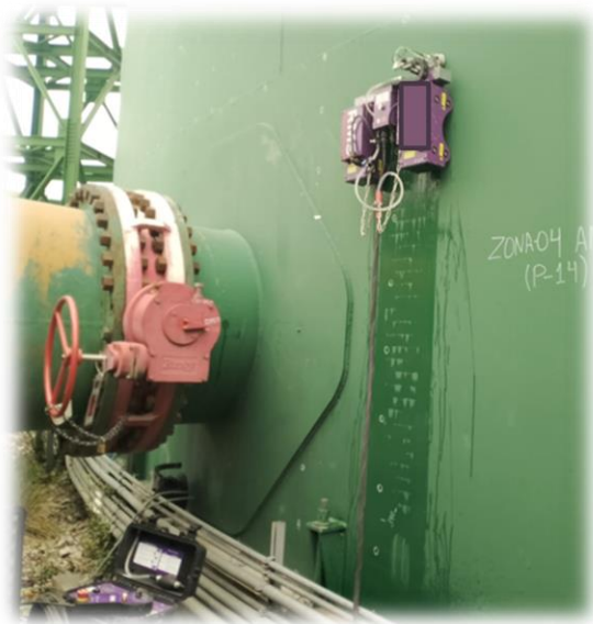
Figura 4. Dispositivo de ultrasonido de toma remota y traslado vertical.
